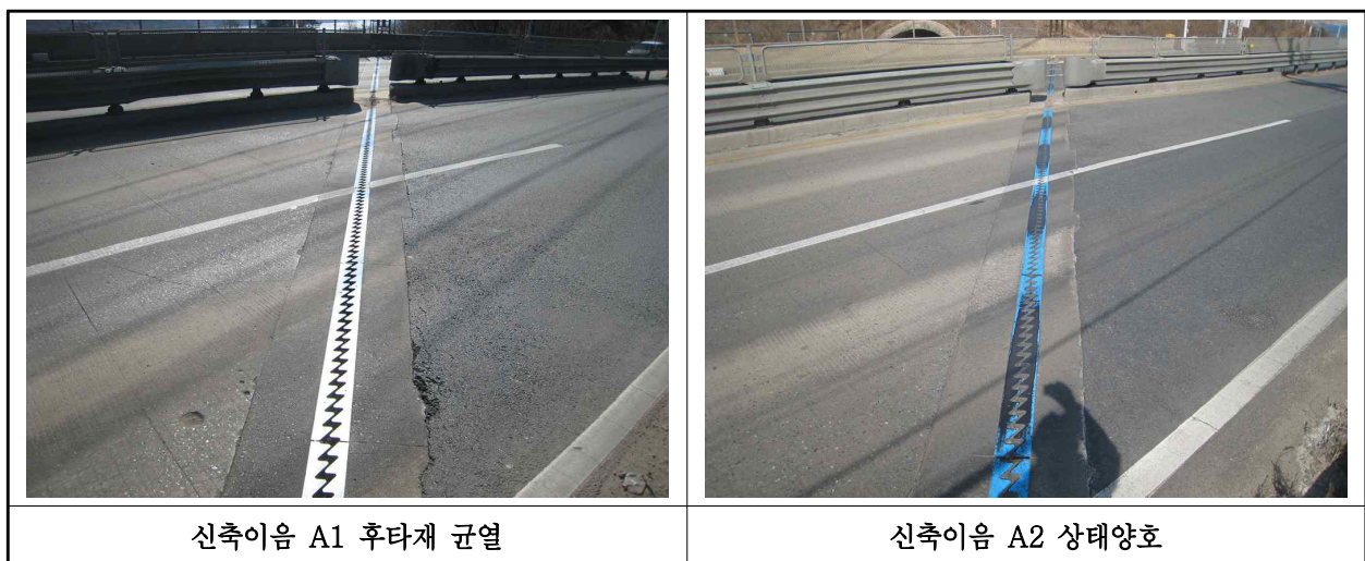
【사진 1.3.15】 신축이음장치 손상현황
