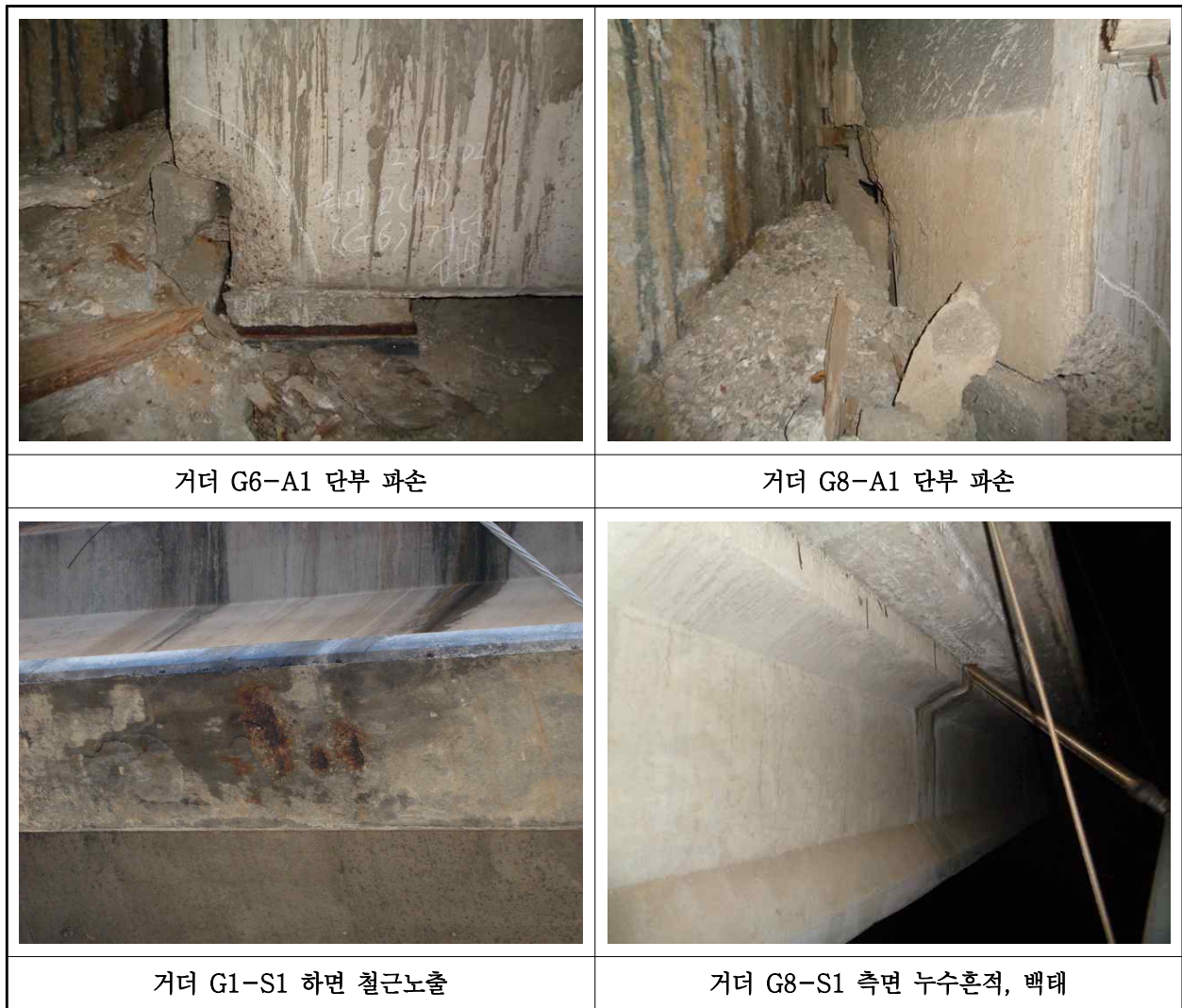
【사진 1.3.5】 거더 손상현황
