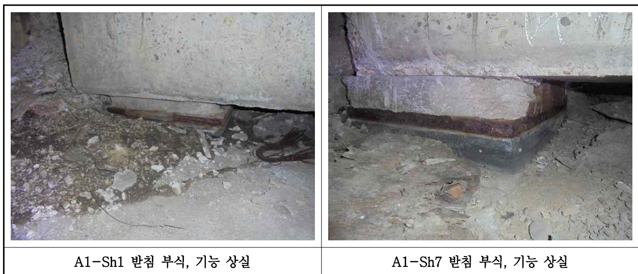
【사진 1.3.11】 교량받침 손상현황
