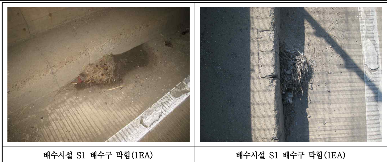
【사진 1.3.20】 배수시설 손상현황
